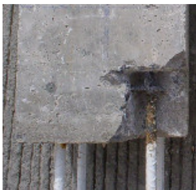
Figura 1. Problema para protección del acero de refuerzo.
